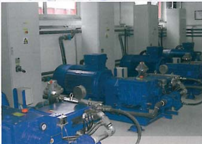
Pomieszczenie z maszynami, urządzenie do czyszczenia zbiorników wewnątrz, Kocioł 800 bar.
