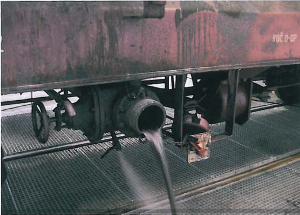
Wyciek brudnej wody z kotła wagonu.
