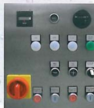
Panel sterowania, obiegowe czyszczenie LCS.
